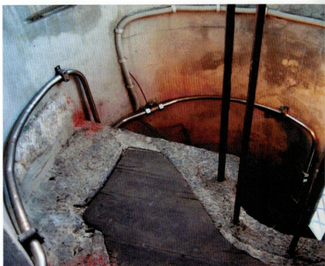
Fig. 2 - I tubi contenenti acqua ad alta pressione salgono nel sottotetto seguendo la curvatura del muro della scala a chiocciola.
