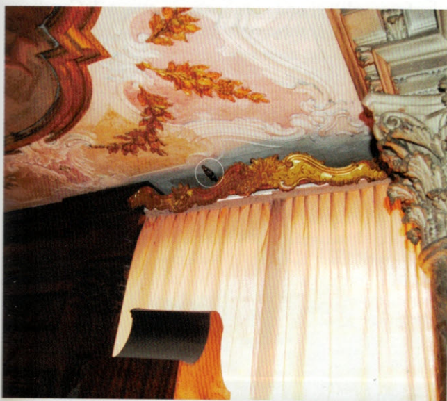
Fig. 3 - Uno sprinkler ben mimetizzato sopra la tenda della Cancelleria vecchia.
